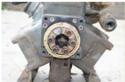
Figura 3 a – Bomba com manchas de fuga de óleo visíveis
